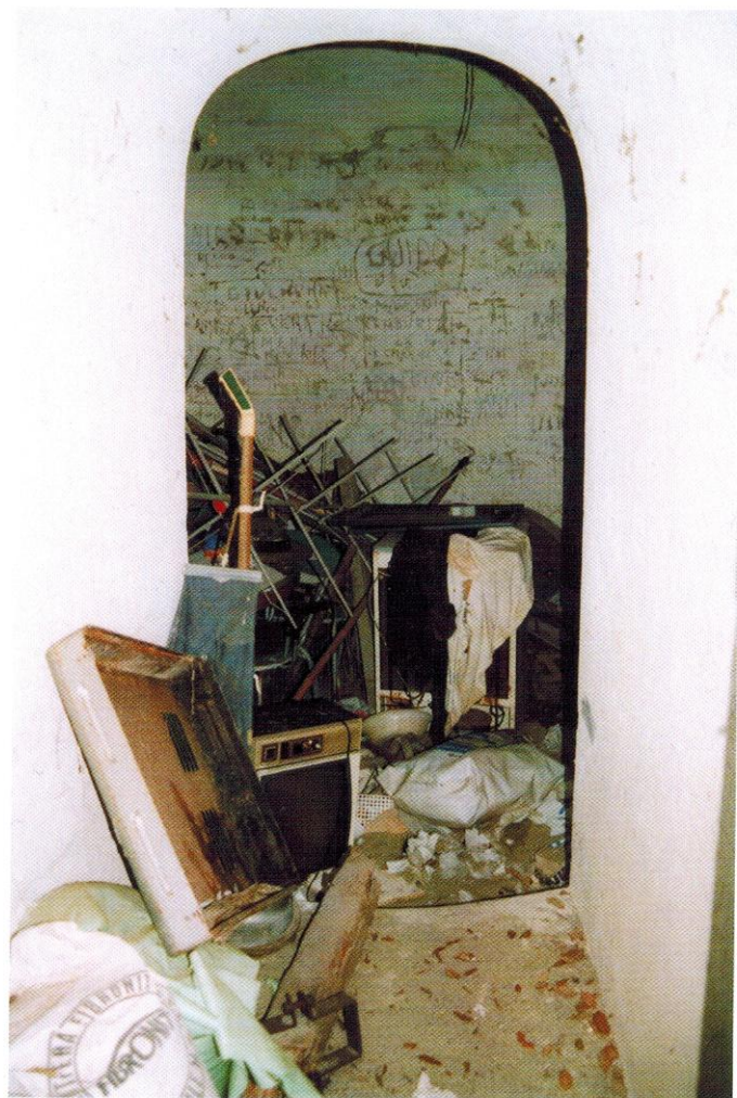
Fig. 5 La stanza di piano terra della Torre Marconi, che è un deposito di rottami e immondizie (foto Paolo Michelini)
