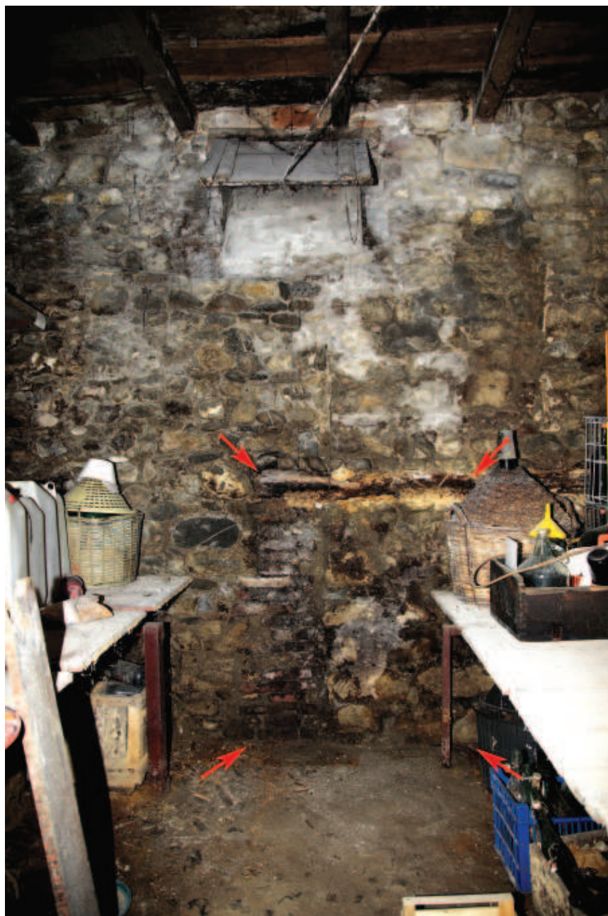
Fig. 7. Casa dell'Oggiola: parete della cantina rivolta verso la strada. Dall'interno, guardando attraverso l'abbaino in alto, si vede che il soffitto della cantina è esattamente al livello della strada. Dalla trave di legno sulla antica porta (porta ora chiusa, indicata nella foto dalle 4 freccette rosse) al soffitto ci sono quasi due metri. Considerando che la porta poteva essere alta 180, 200 cm, altezza che è attualmente diminuita dall'innalzamento del pavimento della cantina. Si può dedurre che il livello della strada in quel punto sia stato innalzato di almeno 3,5 metri (fotografia di S. Muratori).
