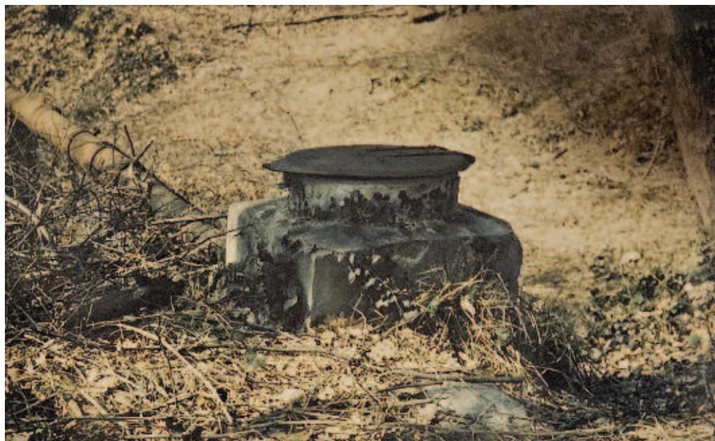
Fig.4. Pozzetto in ferro per le ispezioni (foto Ugo Guidoreni).
