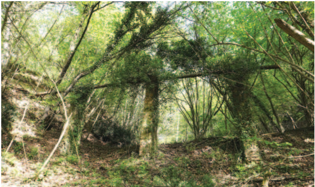
Fig.12. Tubazione su pilastri del tratto più a monte, 2024 (foto Mauro Filippini).
