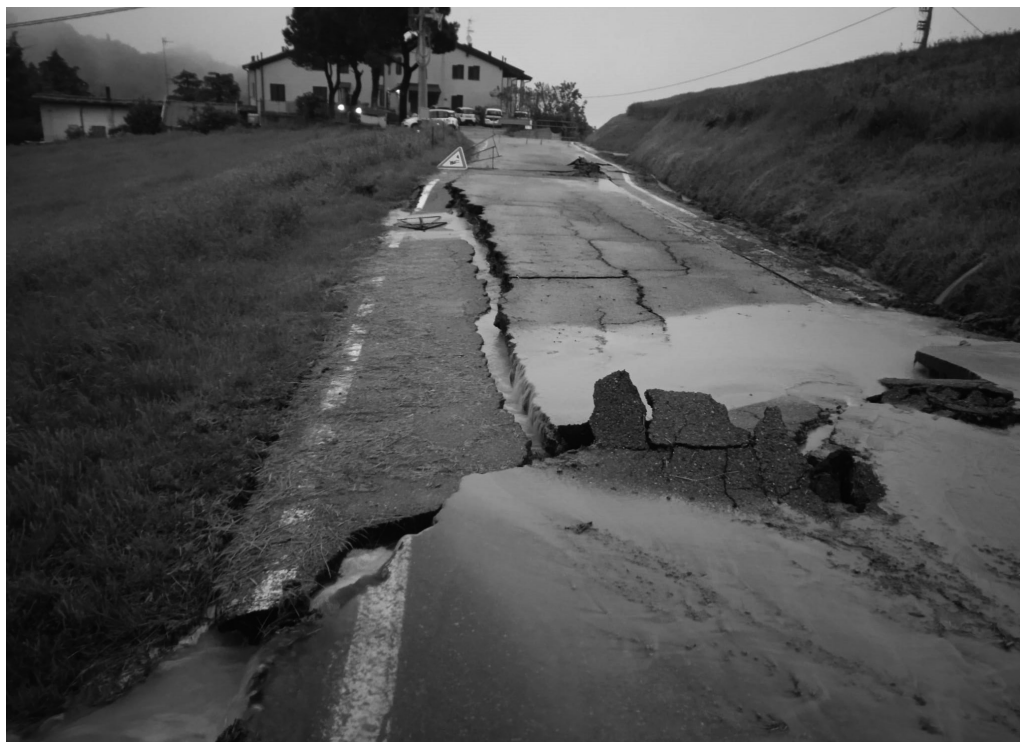
Fig. 11. Maggio 2023, l'emergenza maltempo: il cedimento della strada di via Tignano (foto Alessandro Raschi).
